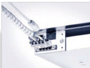
CONEXIÓN ENCHUFE GENERADOR
