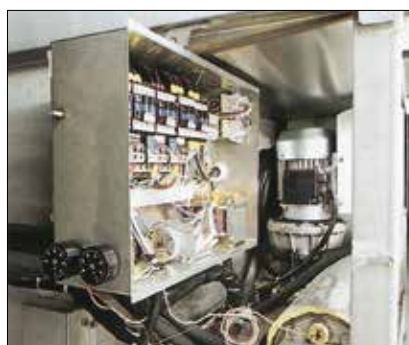
Cuadro eléctrico LP-67
